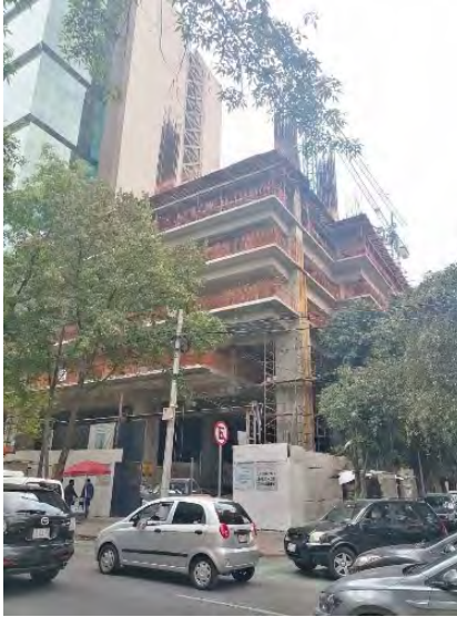
Estado actual de la construcción irregular ubicada en Insurgentes Sur 1921
