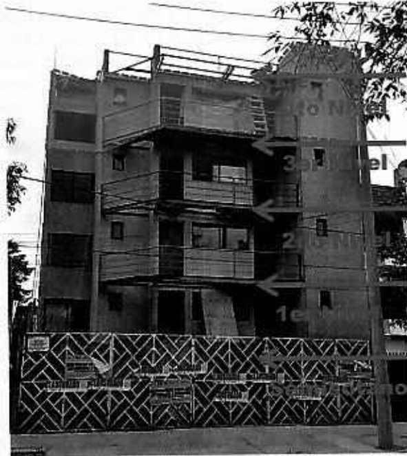
Imagen No. 1. Fuente PAOT, reconocimiento de hechos de fecha 09 de junio de 2017. (Se marca con línea punteada los niveles que se encuentran rebasando la zonificación actual establecida en el PDDU-Coyoacán)
