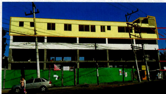
Junio de 2017, se constató la construcción de un inmueble de 4 niveles de altura y un semisótano en etapa de obra negra, con sellos de clausura por parte de la delegación Tlalpan. No se observó letrero de obra
