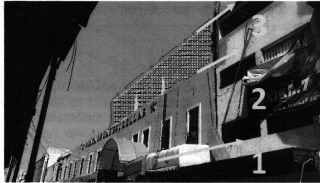
Imagen No. 1. Fotografía tomada en el reconocimiento de hechos de fecha 9 de febrero de 2017, del predio objeto de investigación, se aprecia el desplante de un tercer nivel.
