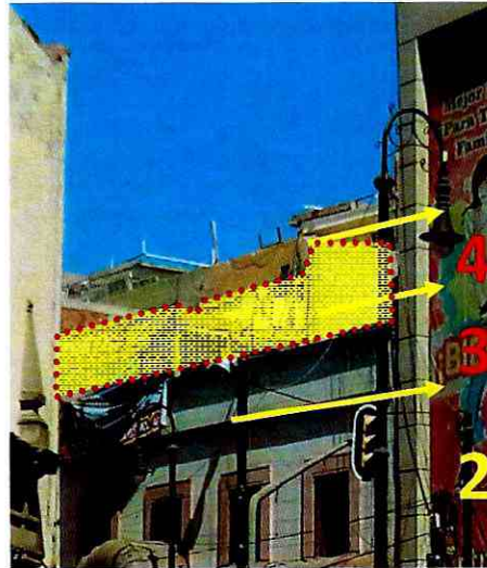
Imagen No. 2. Fotografía tomada del costado del inmueble, se aprecia que en la azotea de la plaza, se realizó la ampliación de 2 niveles.
